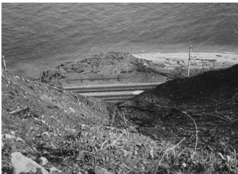
Рис. 2. На берегу Байкала остатки оползня-сплыва, повредившего железнодорожное полотно, 1971 г.
