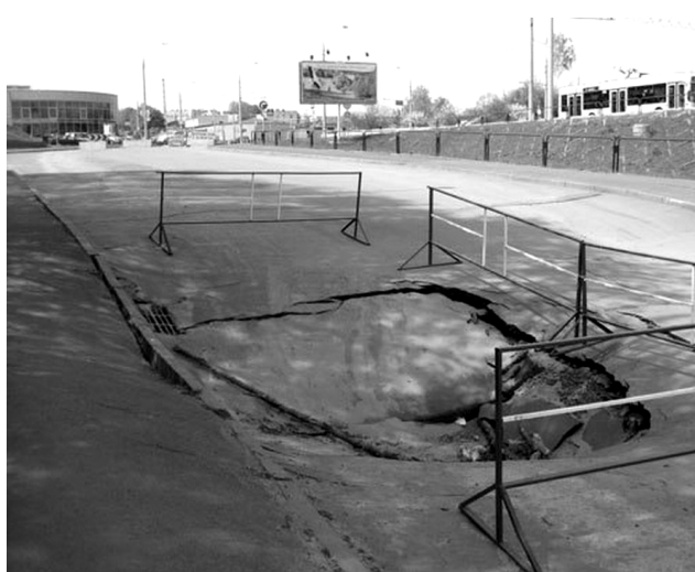
Рис. 6. Проявление суффозионных процессов (эстакада на ул. Подгорной со стороны путепровода по ул. Хатаевича г. Гомеля)
